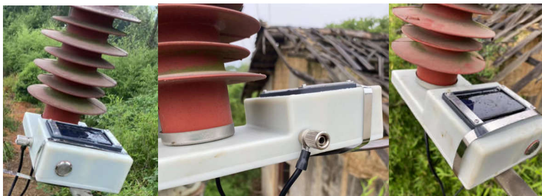
图 9 配网避雷器在线监测装置现场安装图
